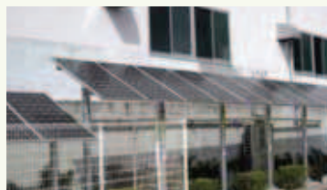
太陽光発電システム(クリーンセンター)
