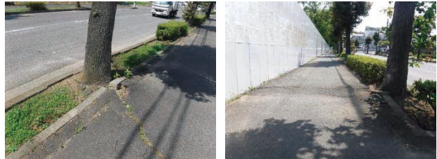
図2-14 街路樹による路面の損傷例
