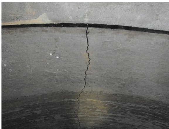
損傷（ひび割れ）
