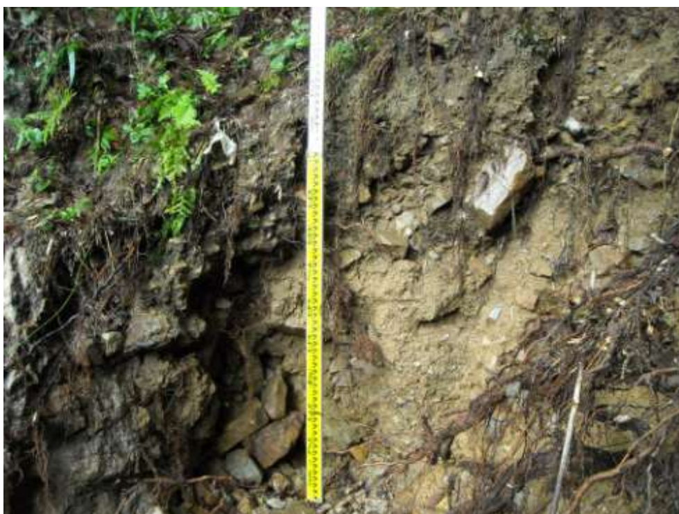
崩落面 石垣及び背面の土層堆積露出状況(南東から)
