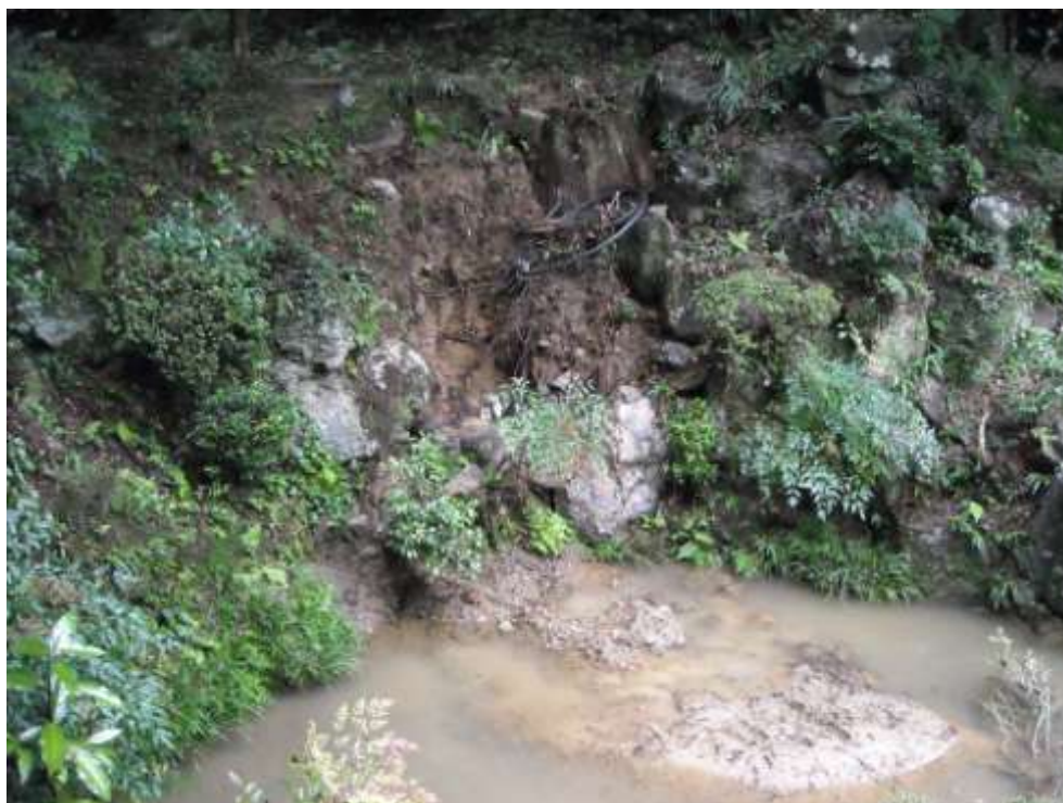
庭園最奥部法面崩落状況(南から)
