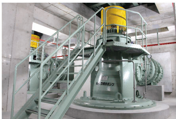
南部ポンプ場
