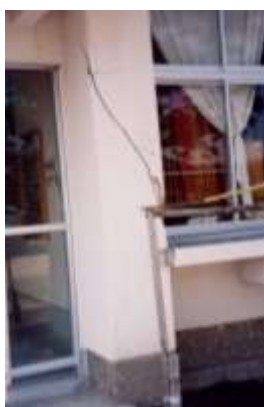
柱へのひび割れ 〔クレジットカードが入る 程度のひび割れ〕
