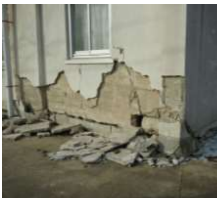
建物全体の破壊・傾斜・変形 壁などへの大きなひび割れ
